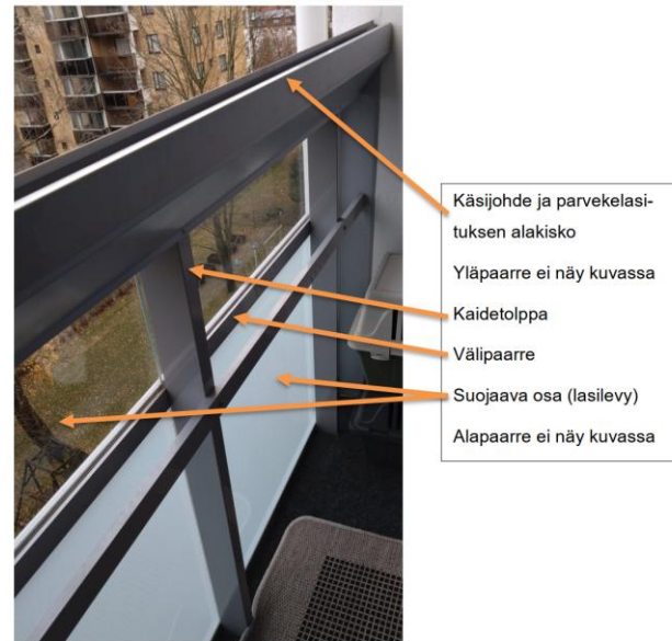
Kuva 3. Kaidejärjestelmä, jossa käsijohde on kiinnitetty parvekelaattaan kiinnitettyihin mastotolppiin ja suojaavana osana on lasilevy. Lasilevyt ovat paarteiden välissä. Kaiteen yläpuolella on parvekelasitus. Käsijohdetta ei ole kiinnitetty parvekepieliin.
