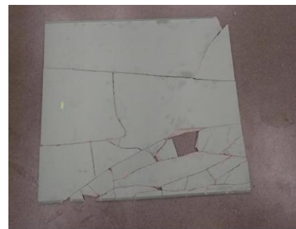
Rikkoontunut onnettomuusparvekkeen levy rekonstruktion jälkeen. Levy on samassa asennossa kuin ollessaan kiinnitettynä alumiinirunkoon, julkisivupuoli näkyvässä. (Kuva: OTKES)
